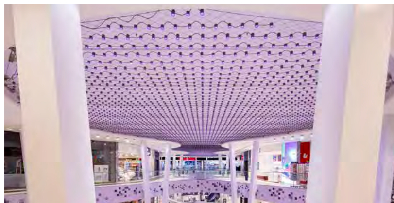
LED-Decke im Stuttgarter Milaneo: Eine großflächige, aber extrem effiziente Lichtinstallation schafft optimale Lichtverhältnisse.
