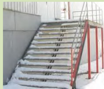
Abb. 32: Vereiste Fluchttreppe [Quelle: ikl]
